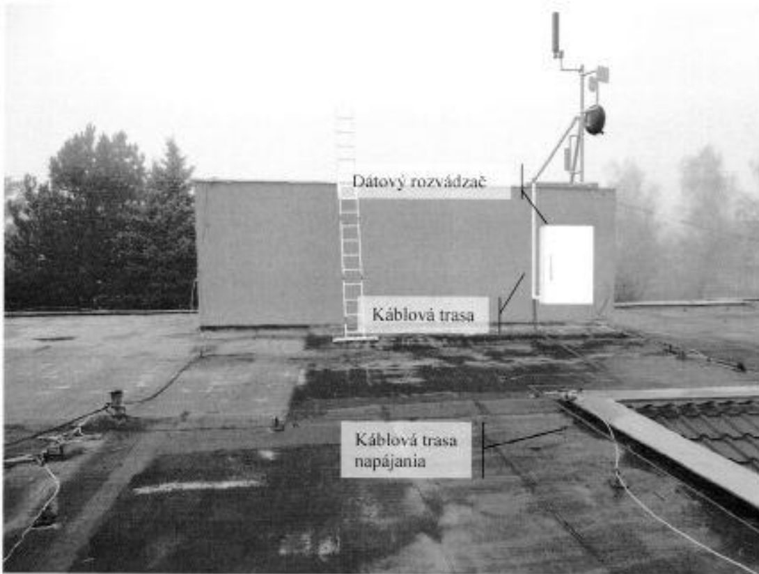
Obr. 2: LTE upevnená na stožiar a dátový rozvádzač.
