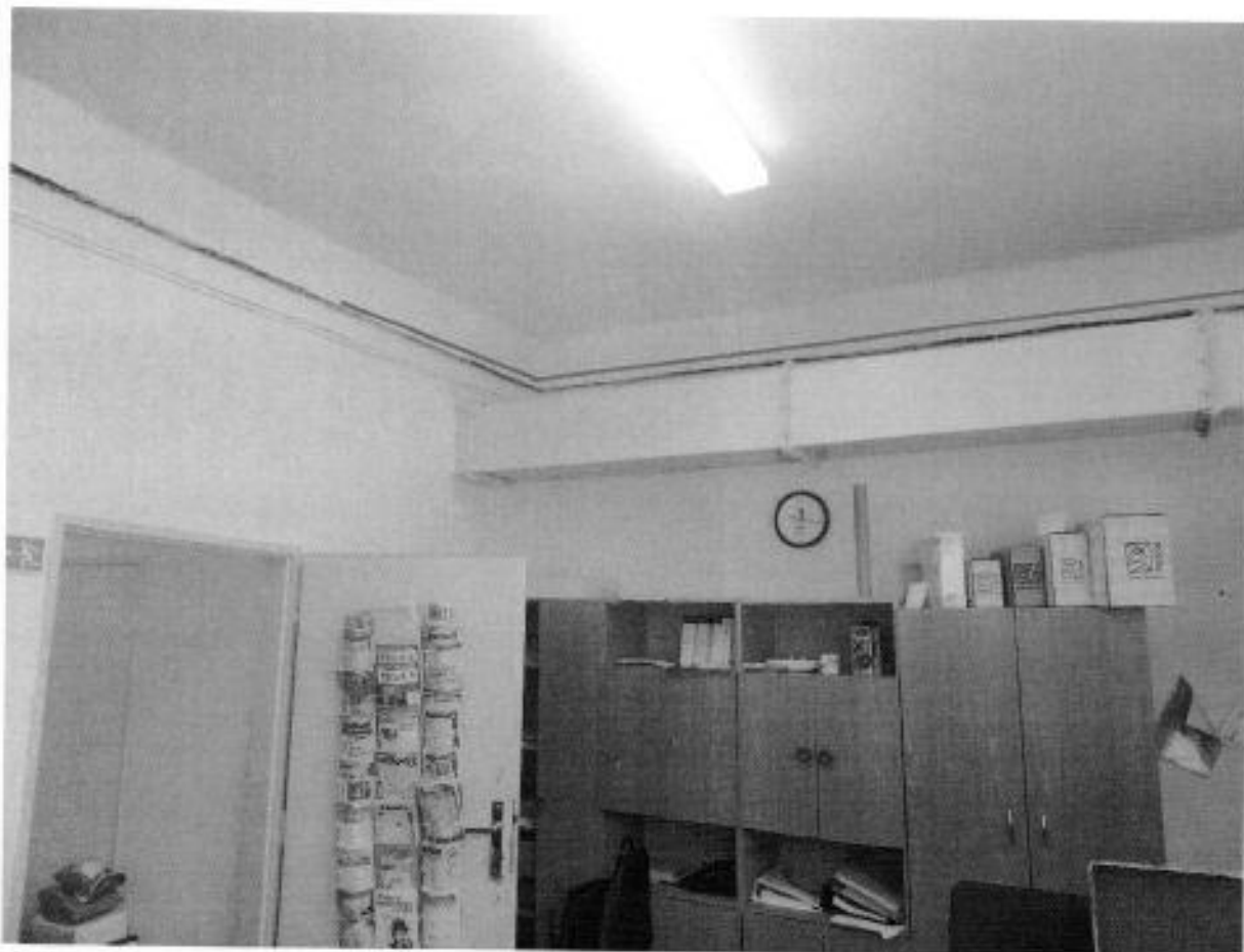
Obr. 7: Káblová trasa do elektrického rozvádzača.
