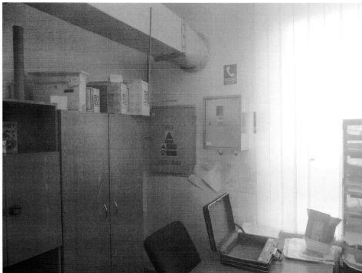
Obr. 8: Káblová trasa do elektrického rozvádzača.
