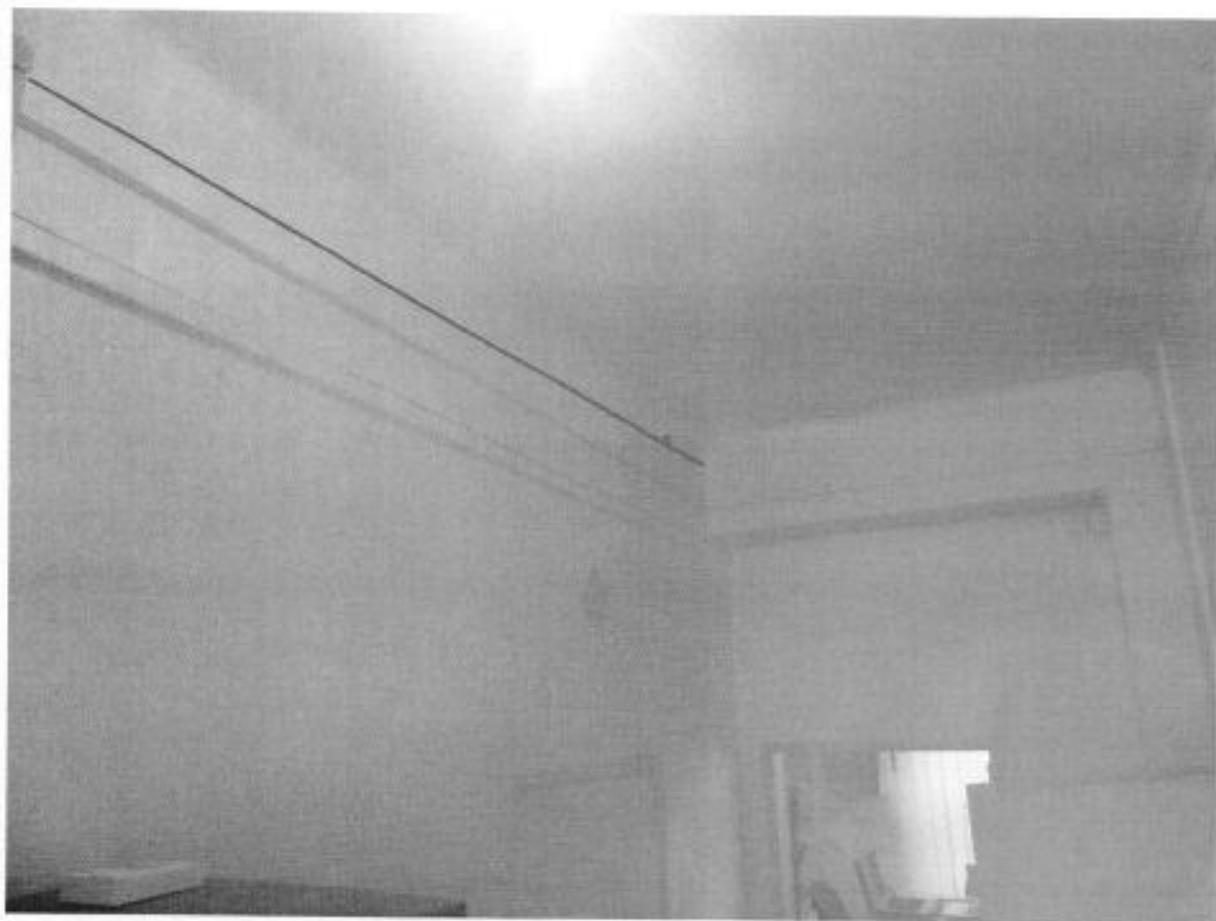
Obr. 6: Káblová trasa do elektrického rozvádzača.
